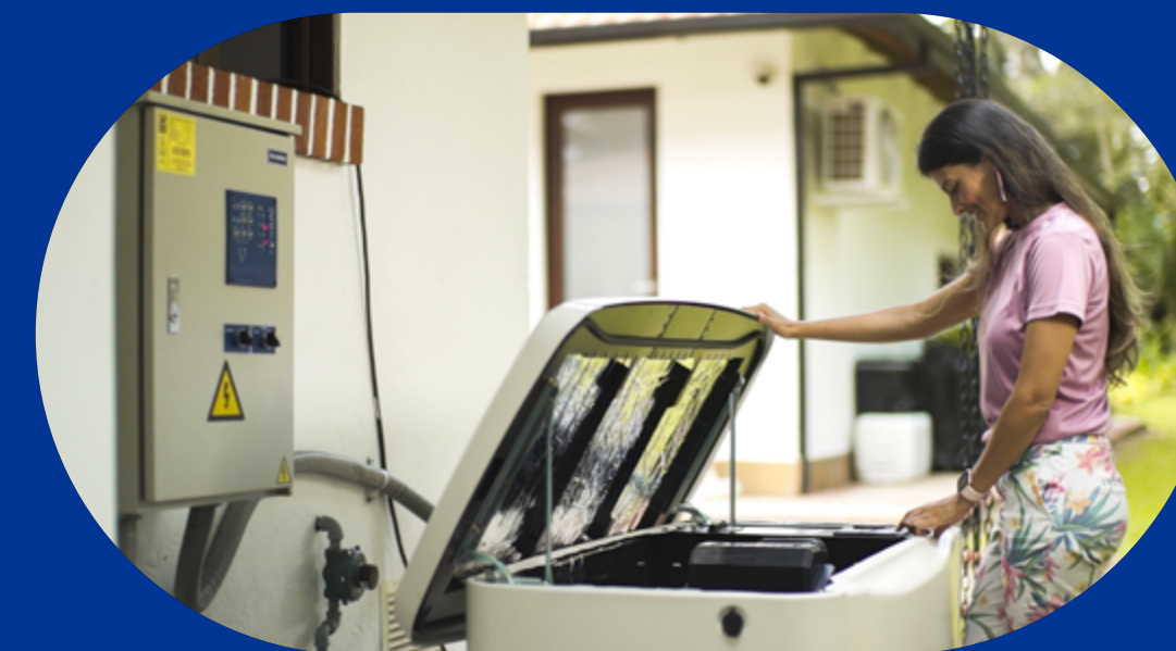
Cogeneración de energía
